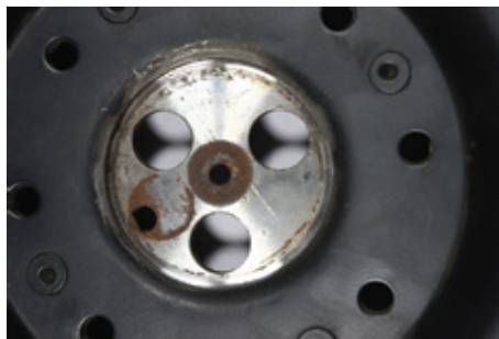
Brak koła ustalającego, korozja (fot. 6)
